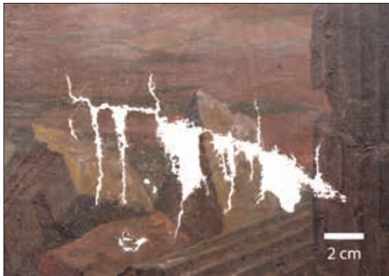
Abb. 185 Riss c/d: Kittung
