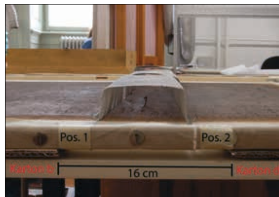
Abb. 150 Riss a/c, Seitenansicht (Spannkante a)
