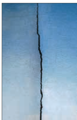
Abb. 118 Oberflächenreinigung entlang Riss a-c
