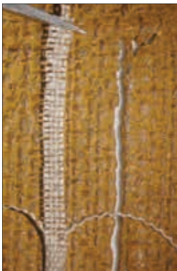
Abb. 179 Riss a/c, oben: Vorzustand
