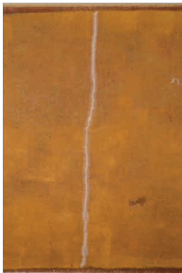
Abb. 182 Riss a/c, Gesamtaufnahme: Endzustand
