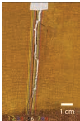
Abb. 173 Riss a/c, unten: Vorzustand mit markiertem Fadenverlauf
