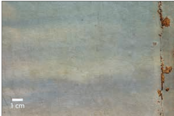
Abb. 129 Bereich des Himmels, rechts mittig (Spannkante b): gelbliche Fleckigkeit
