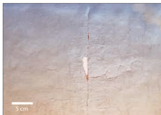
Abb. 125 Riss a/d, Gesamtaufnahme, nach der mechanischen Abnahme der Überarbeitung: bräunlicher Schleier ringsum den freigelegten Bereich
