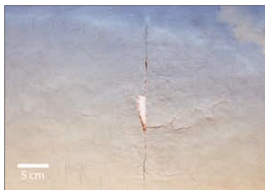
Abb. 135 Riss a/d: nach Reduzierung des Überzugs
